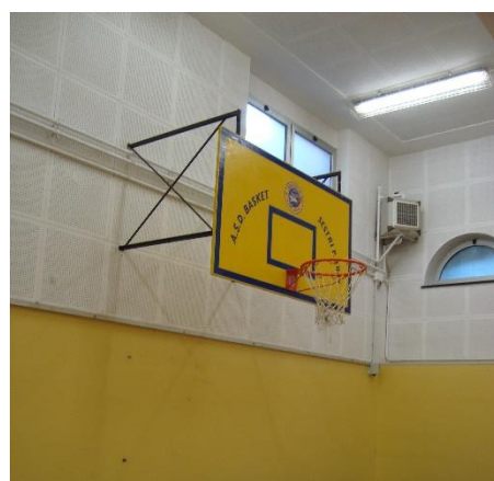
Figura 4.7 - Particolare aerotermi palestra
