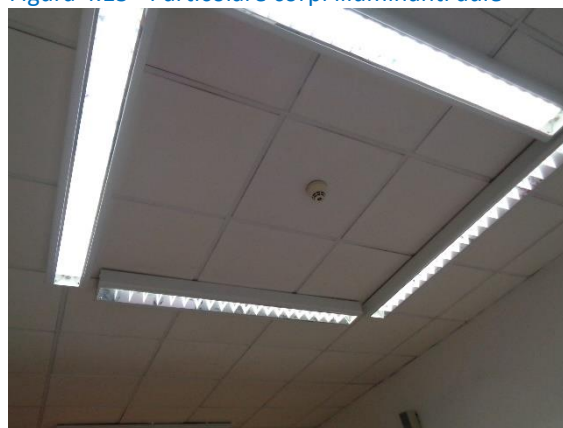
Figura 4.15 - Particolare corpi illuminanti aule
