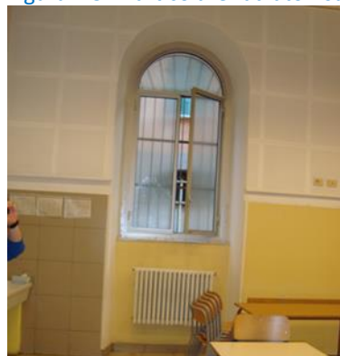
Figura 4.5 - Particolare radiatori su parete esterna
