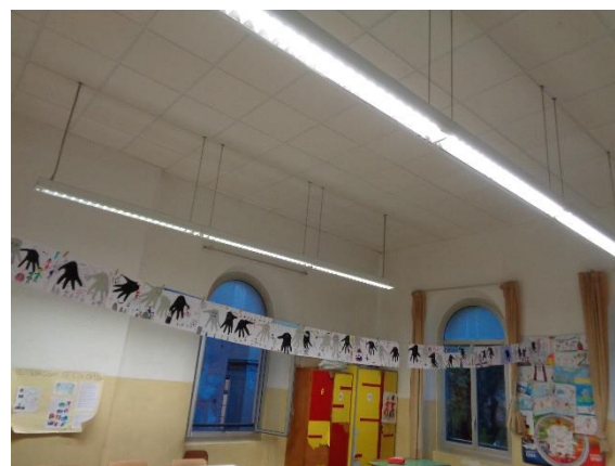
Figura 4.17 - Particolare dei corpi illuminanti ubicati nelle aule
