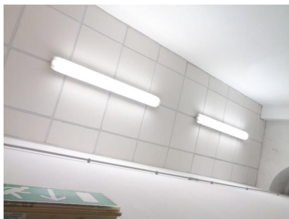
Figura 4.16 - Particolare dei corpi illuminanti ubicati nella mensa
