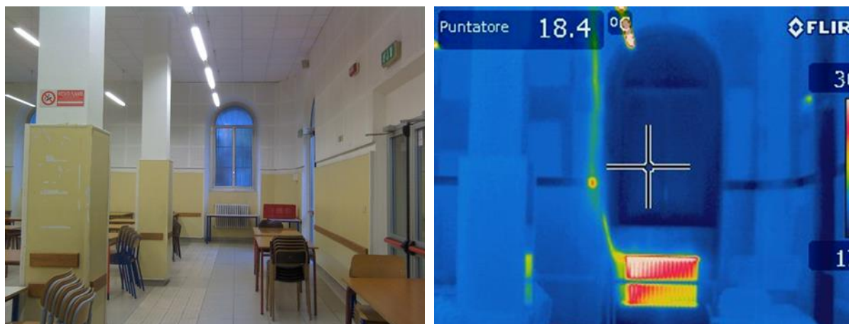
Figura 4.4 – Rilievo termografico serramenti sala mensa
